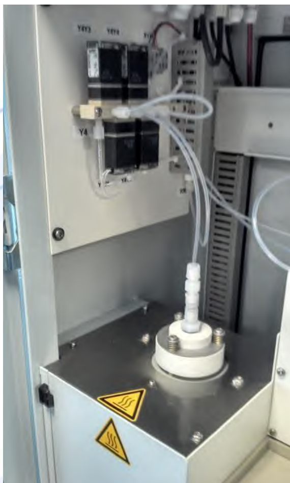
Détails des vannes et du port d'injection
